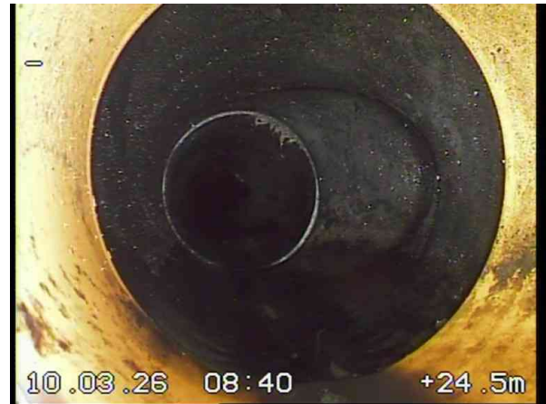
6, 00:03:51, 24.50m Rohrmaterialwechsel: unbekannter Kunststoff
