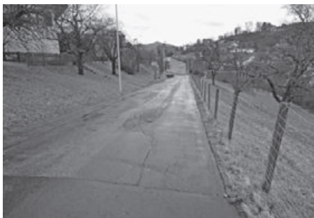
Die sanierungsbedürftige Rebbergstrasse in Oberflachs.
