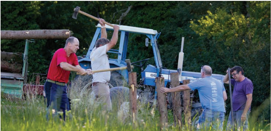
Bau des Rostes: Der Rost besteht aus senkrecht eingeschlagenen Pfählen, einer Querstrebe und mehreren Längsstreben. Er dient dazu, dem Feuer ein horizontales Fundament zu geben und die Luftzufuhr von unten zu gewährleisten.
