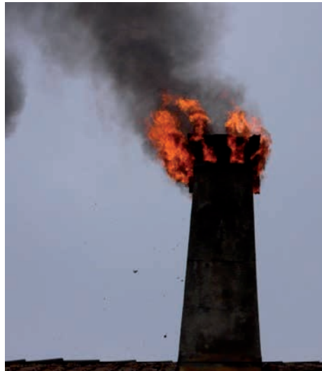
Aussenansicht bei einem Kaminbrand im Oberdorf von Schinznach-Dorf.
