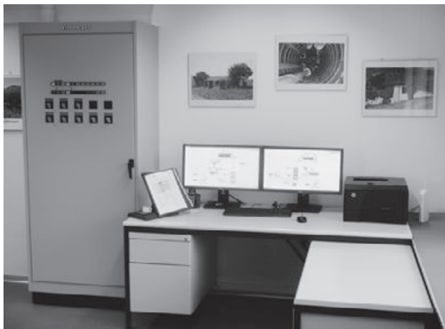
Die Betriebswarte der gesamten Wasserversorgung des Schenkenbergtales und der A3.
