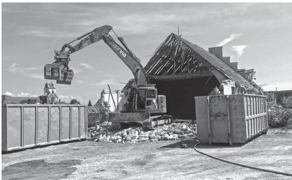
Die Abbrucharbeiten legen den Blick frei auf die moderne Holzkonstruktion aus dem Jahr 1923.
