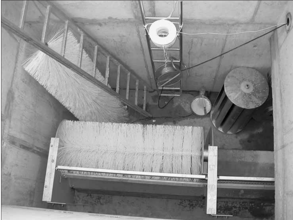
Beckenüberlauf mit Bürstenrechen
